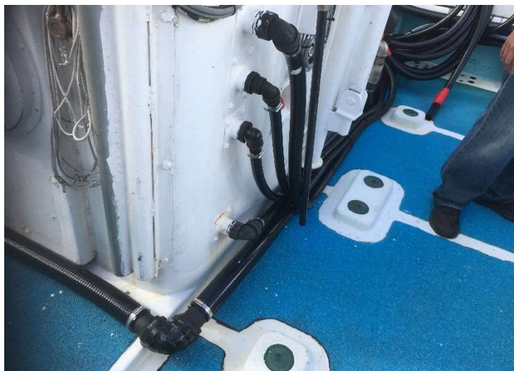
↑ 主機関、補機、冷凍機へ海水を循環。
